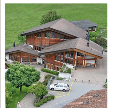
Das Dach des Kirchgemeindehauses von Reichenbach muss saniert werden. Foto: nik
