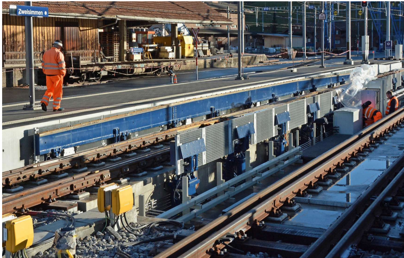
Die Umspuranlage im Bahnhof Zweisimmen steht. Die Testfahrten sind Anfang 2019 geplant. Foto: Guido Lauper
