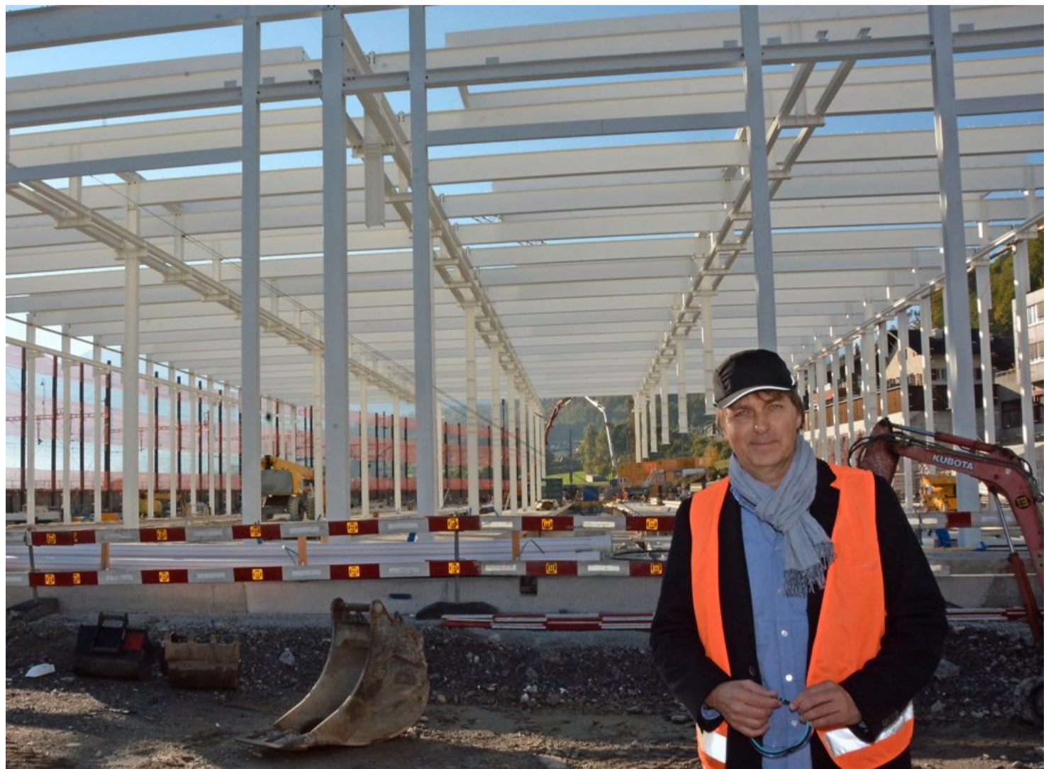
Gesamtprojektleiter Thomas Hempel vor der künftigen 145 Meter langen Halle der BLS-Werkstätte Spiez: «Wir hoffen, den Bau bis zum Dezember winterfest machen zu können.»
