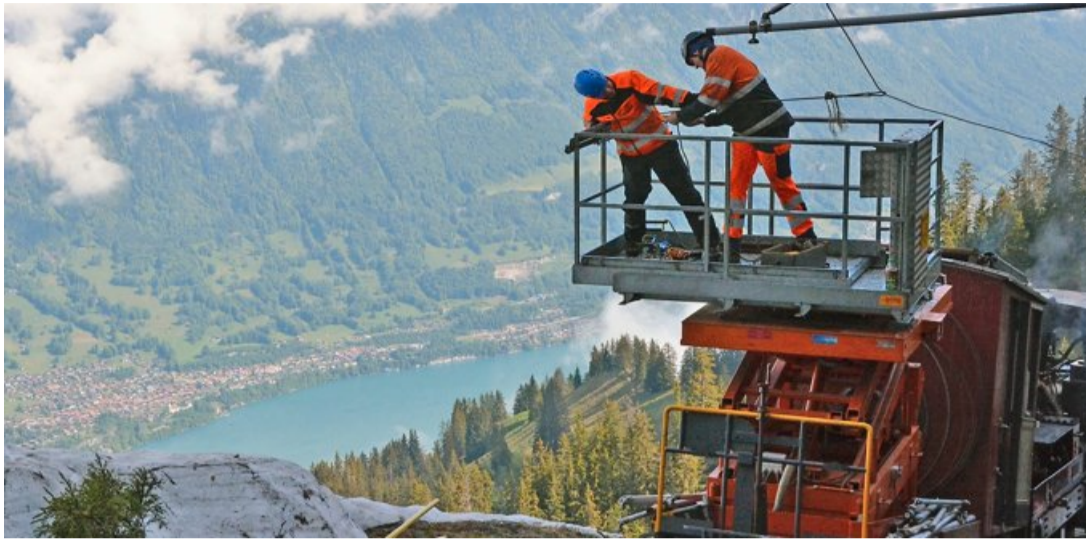
Hoch über dem Brienzsee: Bevor die Schynige-Platte-Bahn wieder verkehrt, montieren die Männer die über den Winter niedergelegte Fahrleitung neu.
