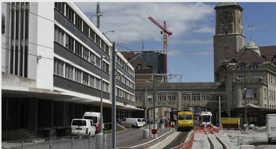
St.Gallen: Die Gleise des Durchgangsbahnhofs sind bereits verlegt. Dahinter ist die provisorische Abfahrtsstelle der Züge nach Appenzell und Trogen. Bis im Oktober 2018 werden noch zwei neue Aussenperrons der AB erstellt.
