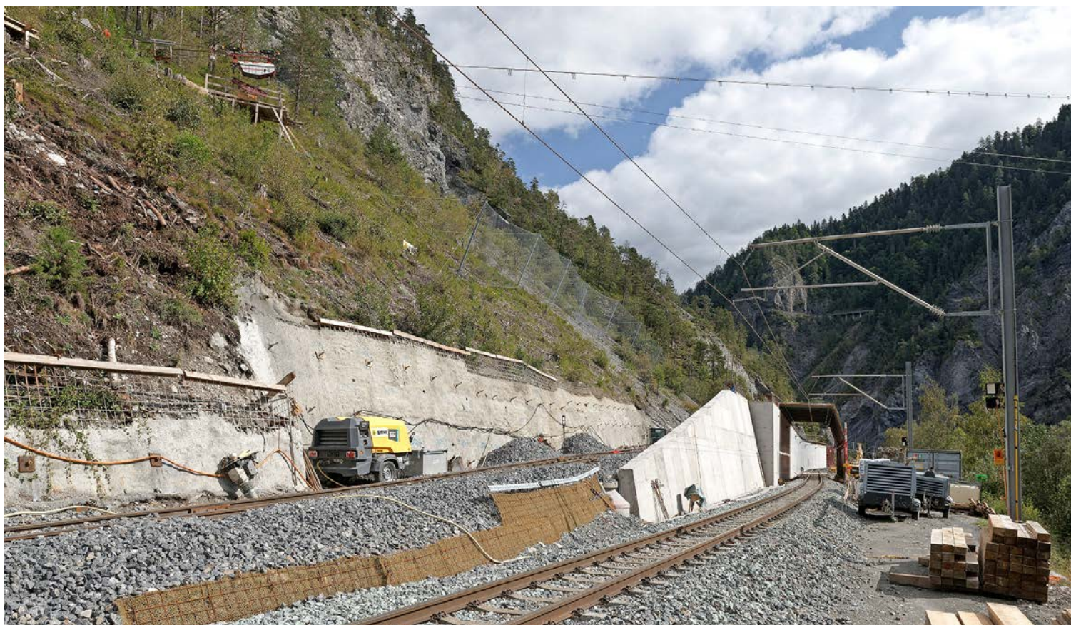
Einblick in die Baustelle, nach links abzweigend wird ein Gleis für die Zuführung des Hinterfüllungsmaterials erstellt.
