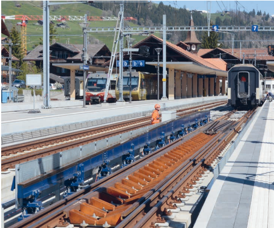
Demonstration der Umspuranlage in Zweisimmen am 1.5.2019 mit dem Bs 221 mit den Vorserien-Drehgestellen EV18 und dem ABe 4/4 9303: Der Wagen fährt von der Normalspur herkommend zuerst über die vier pfeilförmig angeordneten Gegenführungen für das Eingreifen der drehgestellseitigen absenkbaren Führungszapfen des Hydrauliksystems, womit die Räder auf dem Spurkranz über die Abstützfläche ins Meterspurgleis rollen, anschliessend wird der Wagenkasten kontinuierlich um 185 mm abgesenkt. Fotos: S. Frei
