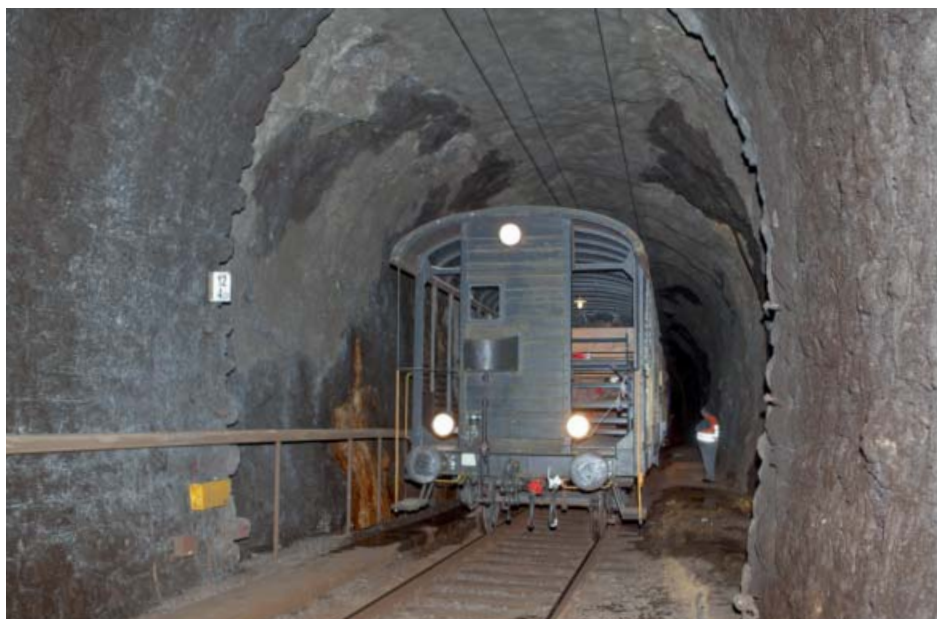
Eine Journalistengruppe hatte Mitte April Gelegenheit, den Weissensteintunnel mit dem Tunnelkinozug zu erkunden. Rund vier Fünftel des Gewölbes sind mit einem Naturstein-Mauerwerk verkleidet; hier der Übergang zu einem Abschnitt mit unverkleidetem Fels (Foto: A. Schmutz).
