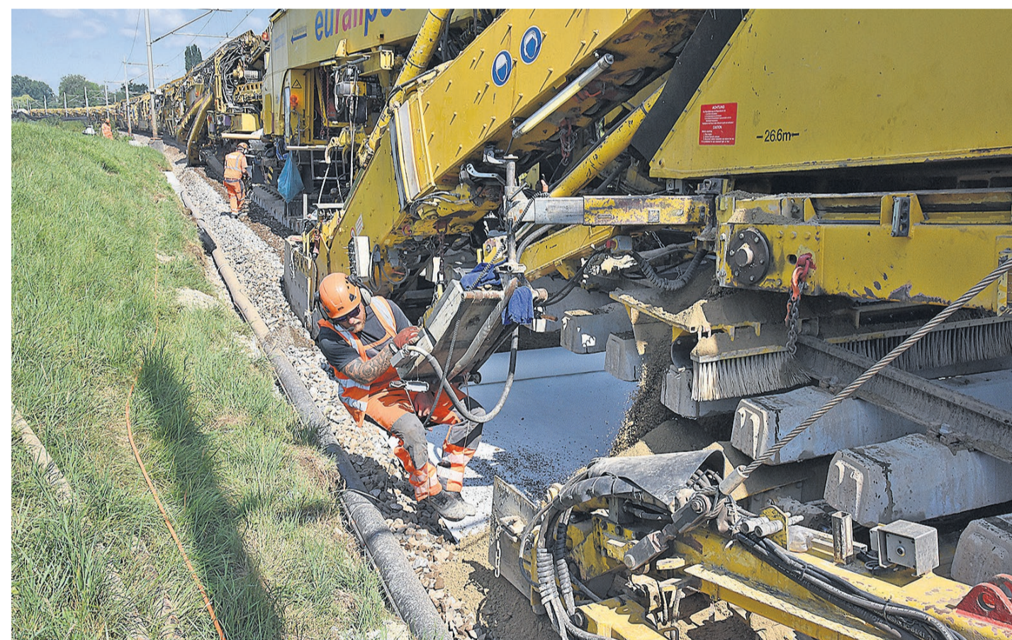
Von diesem luftigen Arbeitsplatz aus überwacht der Maschinist das Auftragen der neuen Planumsschicht aus Kiessand. Das Bild gibt auch einen Eindruck von der gewaltigen Länge der fahrbaren Gleisfabrik.
